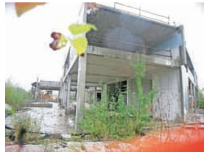
Po neuspešni prvi prodaji, v kateri je bil kompleks Center Komenda naprodaj za 2,8 milijona evrov, stečajni upravitelj in največji ločitveni upnik Gorenjska banka iščeta možnosti za dokončanje objekta. / Foto: Tina Dokl
