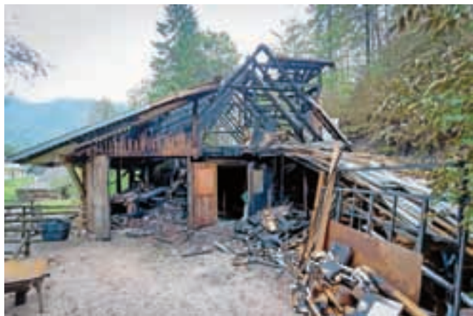
Požar je zajel celotno delavnico. / Foto: Luka Renner
