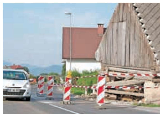
Del ceste je zaradi nevarnosti podrtja hiše še vedno zaprt za promet. / Foto: Gorazd Kavčič
