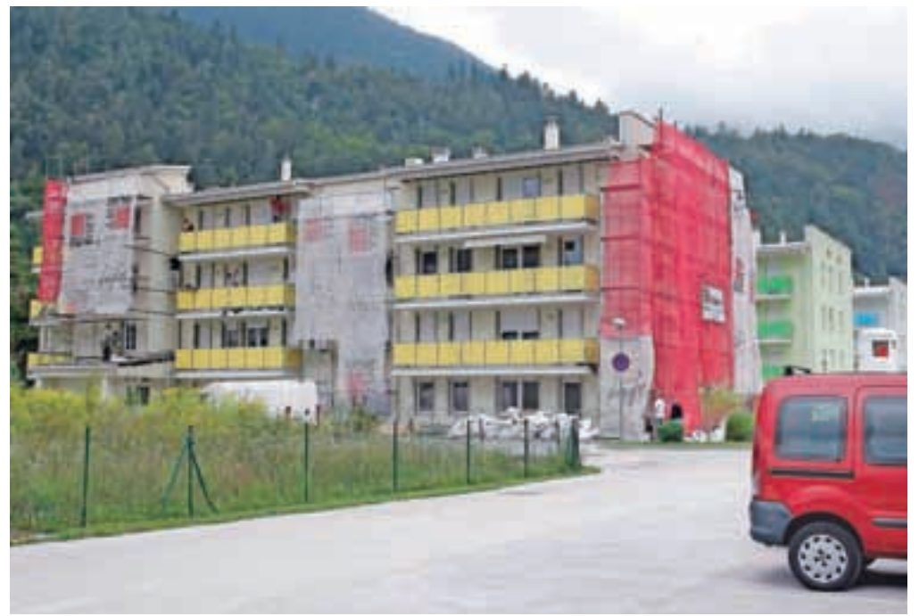
Pri komaj pet let starih blokkih je potrebna temeljita obnova, med drugim morajo prenoviti fasade. Dela naj bi trajala od tri do štiri mesece. / Foto: Gorazd Kavčič
