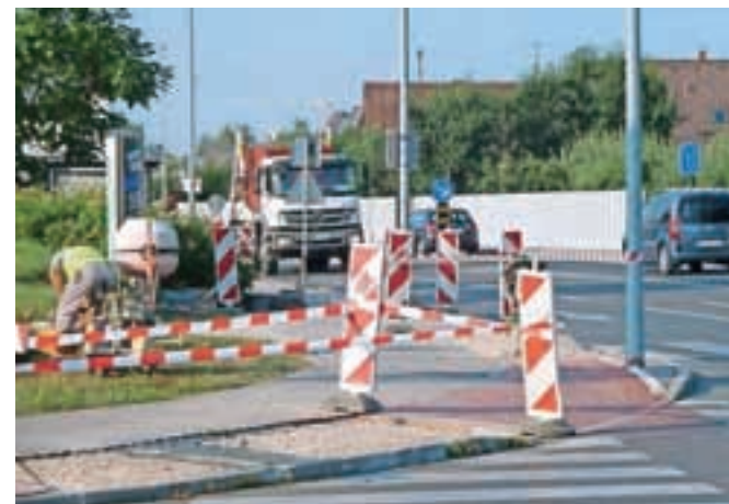
Zaradi del je na omenjenem odseku postavljenih več delnih zapor.
