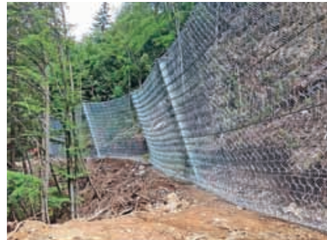
Pod Kamnekom sedaj stoji zaščitna mreža, ki zadrži tudi udarce zelo močnih skal. / Foto: Občina Tržič
