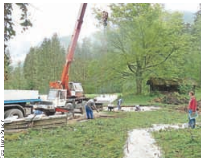
Včeraj so delavci Žurbi Teama takole polagali gradbene odlitke, ki jih bodo v kratkem zmontirali v celoto.
