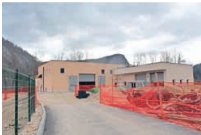
Sodobna čistilna naprava v Bohinjski Bistrici
