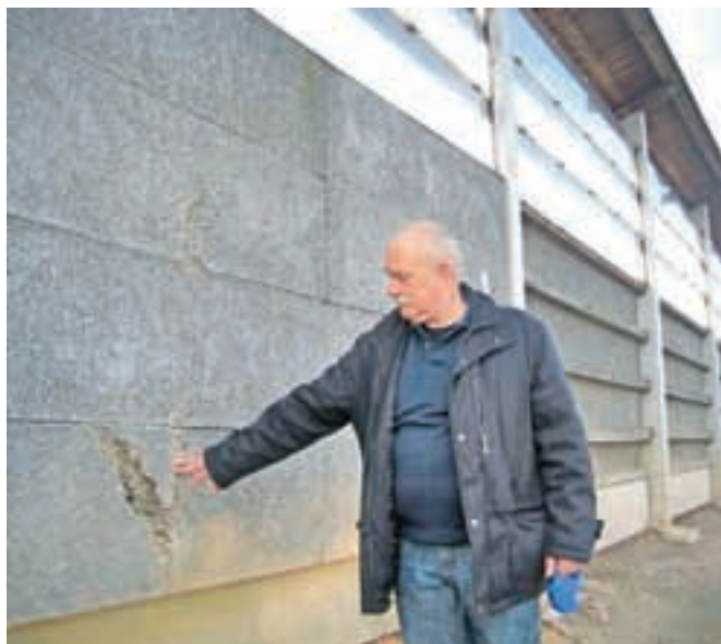
Milan Klemenčič je opozoril na nujno sanacijo protihrupne ograje, ki ne le da svoje funkcije ne opravlja, ampak je tudi že poškodovana.
