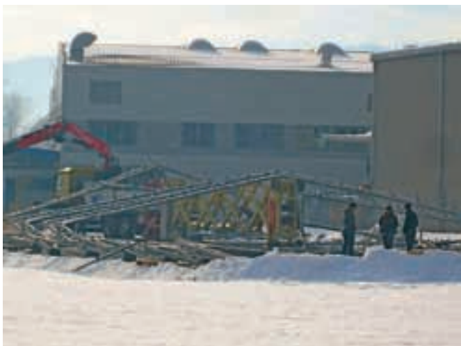
Do delovne nesreče v Filcu je prišlo zaradi zrušitve kovinske konstrukcije šotora.
