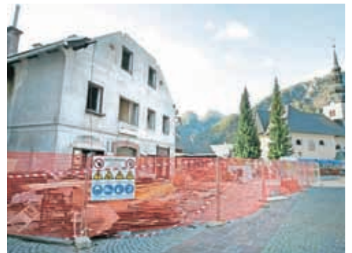
V središču Kranjske Gore gradijo nov Ljudski dom, za katerega občina v proračunu za prihodnje leto namenja dva milijona evrov sredstev. / Foto: Gorazd Kavčič
