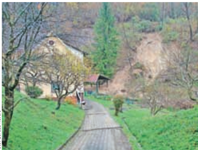
Zemeljski plaz v Seničnem, ki je v petek ogrozil strugo potoka in stanovanjsko hišo, so hitro sanirali.
