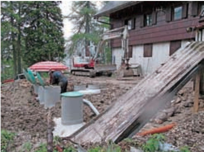
Erjavčeva koča na Vršiču je pred dnevi dobila malo komunalno čistilno napravo.
