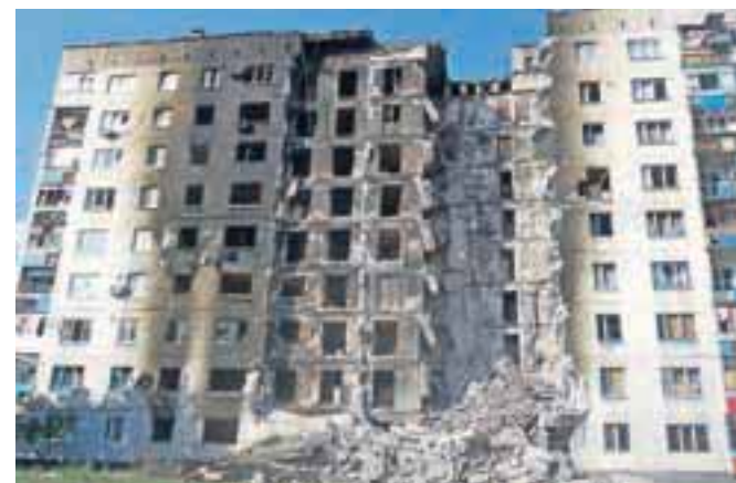
V vojni poškodovana stavba v mestu Lisičansk na vzhodu Ukrajine / Foto: Wikipedija
