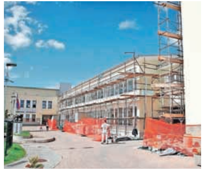
Šola v Žirovnici dobiva novo fasado, prizidek pa bo zgrajen do konca julija prihodnje leto. / Foto: Gorazd Kavčič
