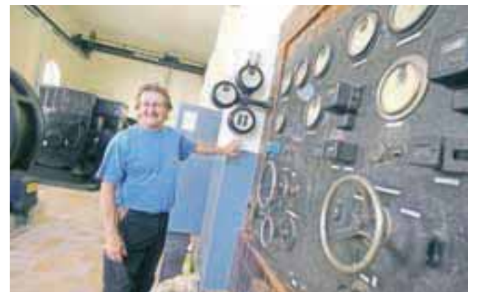
Še pred dvema mesecema je Franc Poljanc ročno upravljaval komandno ploščo v elektrarni v BPT (na sliki), z obnovo je sistem avtomatiziran. / Foto: Tina Dokl
