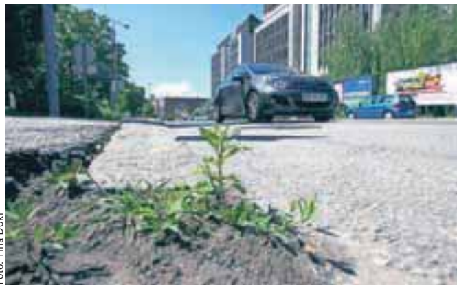
Direkcija za ceste je zaradi pomanjkanja denarja ustavila nekatera vzdrževalna opravila na že tako slabih cestah.
