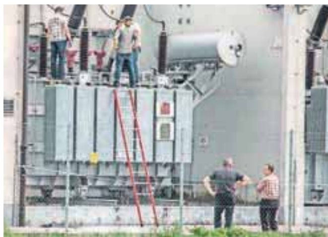
Kranjčana je streslo med krajo bakra na vrhu transformatorja. / Foto: Matic Zorman
