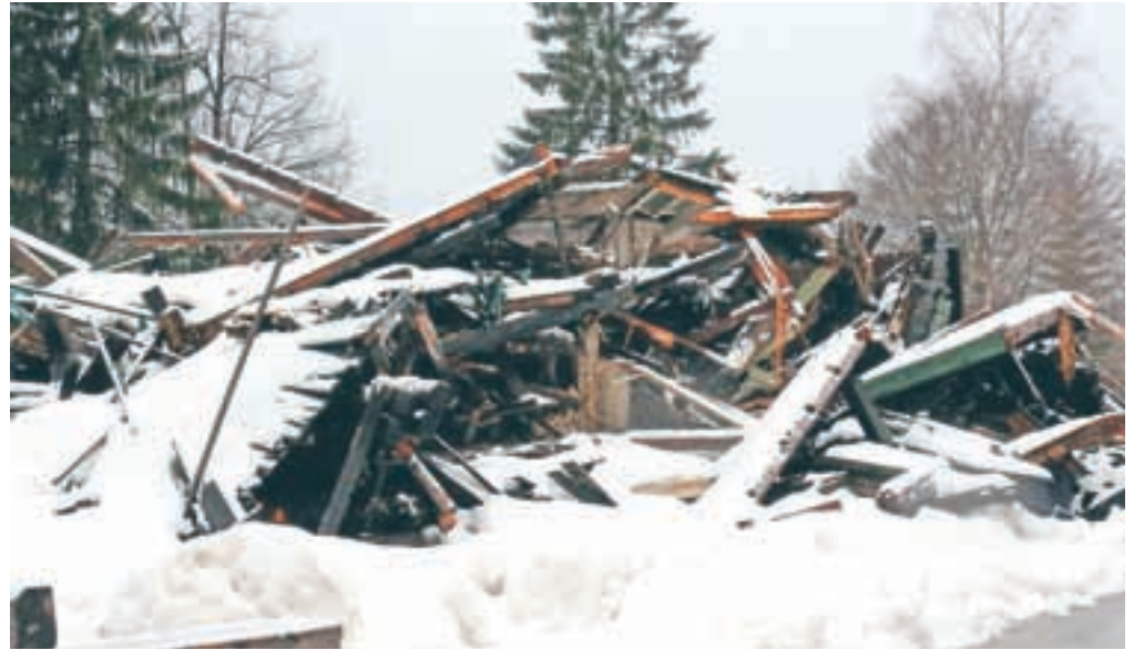
Gradbena inšpekcija je zaradi nevarnosti odredila dokončno porušitev Karadorđevićeve vile.
