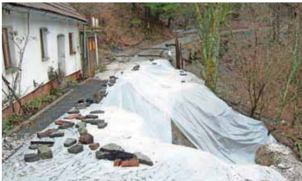
Zemeljski plaz v Podporeznu je utrgal cesto. Prehod je mogoč le peš. /Foto: Občina Železniki
