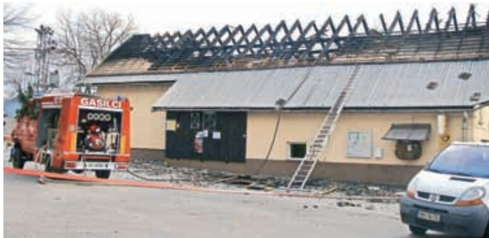
Požar je močno poškodoval kulturni dom na Bohinjski Beli.
