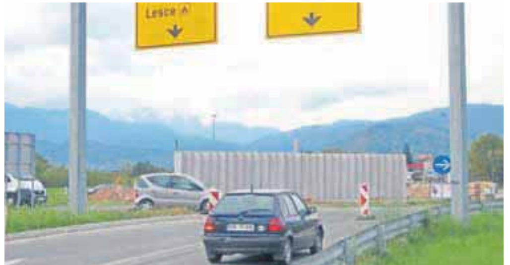
Čeprav že betonski temelji velike skulpture zapirajo pogled na celotno krožišče, na občini Radovljica zatrjujejo, da spomenik ne bo ogrožal prometne varnosti.
