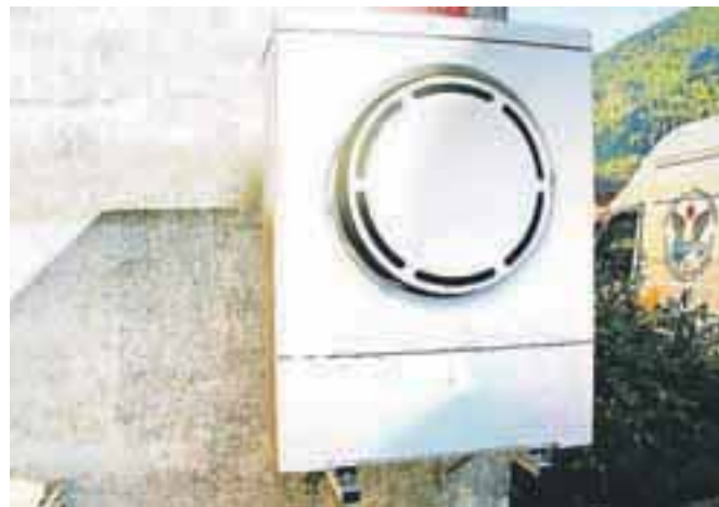
Blok na Ulici Gustla Štravsca je prvi na Jesenicah, ki ima za ogrevanje sanitarne vode urejeno toplotno črpalko. Zunanji del je nameščen na steni bloka.
