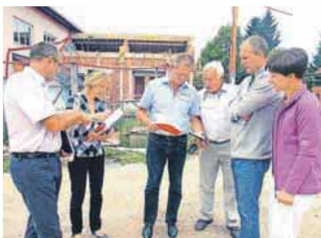
Od leve podžupan občine Naklo Aleš Krumpetar, direktorica občinske uprave Silvana Markič, Marko Mravlja, Marjan Markič, Milan Bohinec in pomočnica ravnatelj Tatjana Lotrič Komac so si pred nekaj dnevi pogledali, kako napredujejo dela v vrtcu in šoli v Dupljah. / Foto: Tina Dokl
