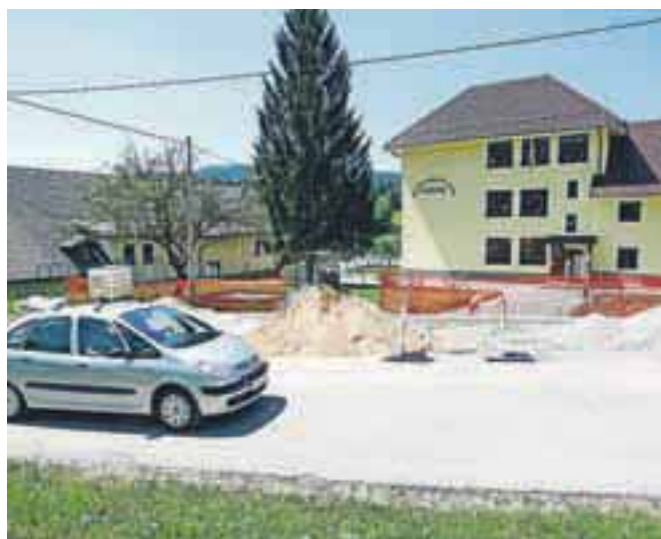
Dela na cesti v Lučinah sedaj potekajo ob šoli in naj bi se do novega šolskega leta zaključila. / Foto: Gorazd Kavčič
