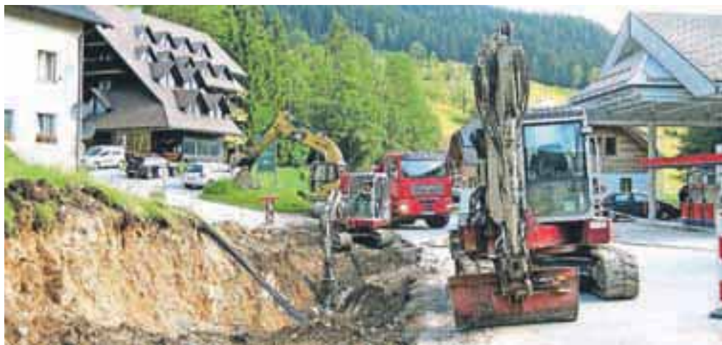
Gradnja kanalizacije je na tem odseku zaradi pestre geološke sestave tal zahtevna. / Foto: Tina Dokl
