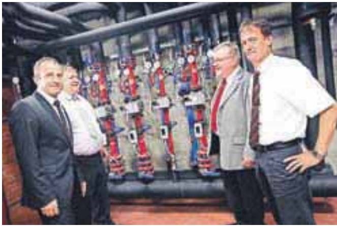
Prenovljena kotlovnica v osnovni šoli na Bledu / Foto: Gorazd Kavčič
