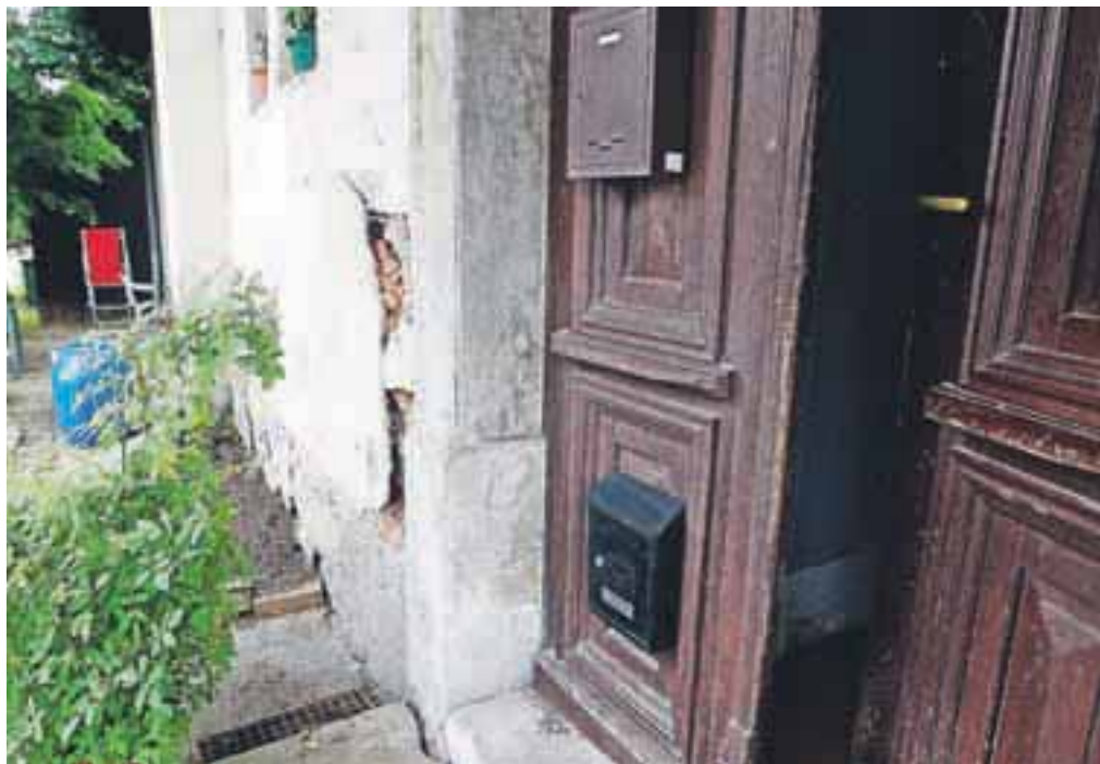
Stanovanjska inšpekcija zaradi nevpisane etažne lastnine ni ukrepala, gradbena inšpekcija je ugotovila, da objekt ni primeren za bivanje. Se mora zgoditi stanovanjsko-bivalni Vegrad, da bi lahko nekdo postal pristojen? / Foto: Gorazd Kavčič
