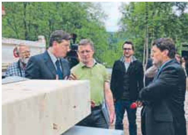
Predsednik Borut Pahor si je ogledal tudi gradbišče novega kolesarskega mostu pri Kampu Danica.
