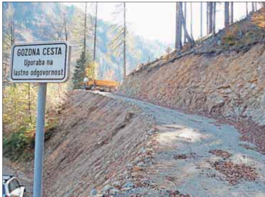
Med gozdnimi cestami, ki so bile zgrajene v obdobju 2007–2012, je tudi cesta Kovkovo na Spodnjem Jezerskem.
