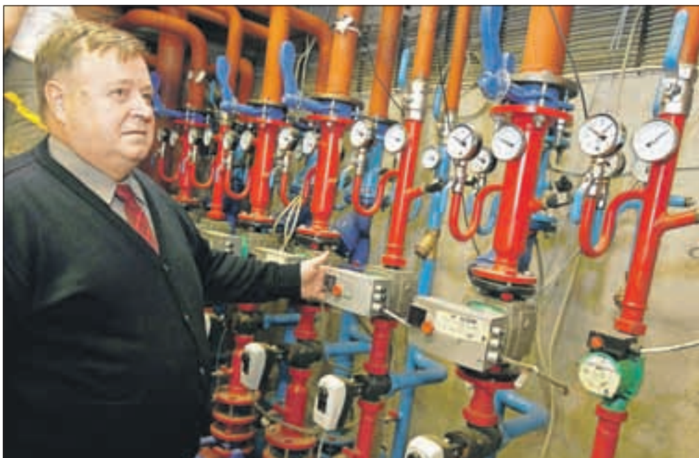
Ravnatelj Osnovne šole dr. Josipa Plemlja Bled Ludvik Hajdinjak v prenovljeni kotlovnici, ki so jo prilagodili novemu sistemu ogrevanja s pomočjo toplotnih črpalk. / FOTO: GORAZD KAVČIČ
