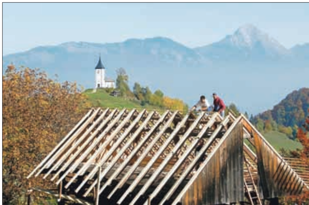
Med obnovo kozolca so na ostrešju okrepili »šperovce« ter zamenjali late in kritino.
