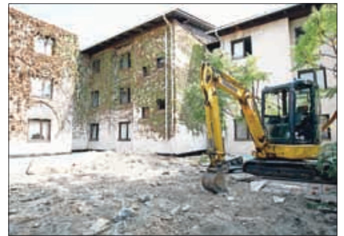
Temeljita prenova stavb kranjskega doma upokojencev se je že začela, zunanja gradbena dela pa naj bi zaključili do konca leta. / Foto: Gorazd Kavčič
