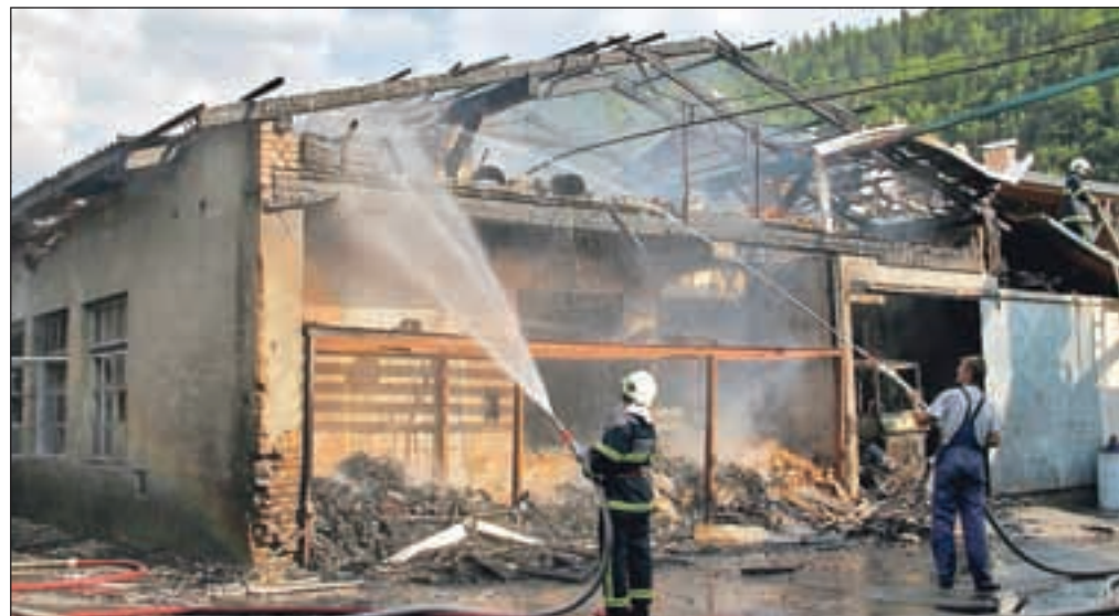
Zgorela je streha nad delavnico žičnikov in tesarsko delavnico ter več strojev in orodja.
