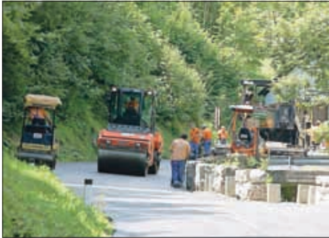
Na cesti Spodnje jezersko-Zgornje jezersko so opravili sanacijo več odsekov v prid prometne varnosti. /Foto: Tina Dokl
