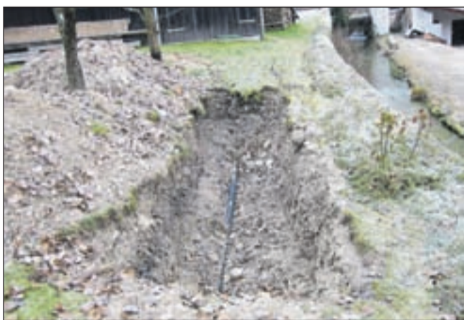
Zaradi odkopane cevi so v Grajskem mlinu ostali brez vode.
