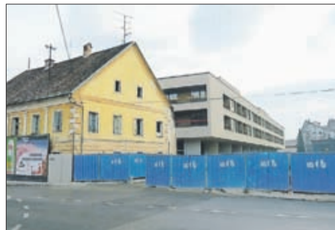
Propadajoča Kančevo hiša in del skoraj dokončanega, a praznega trgovsko stanovanjskega objekta
