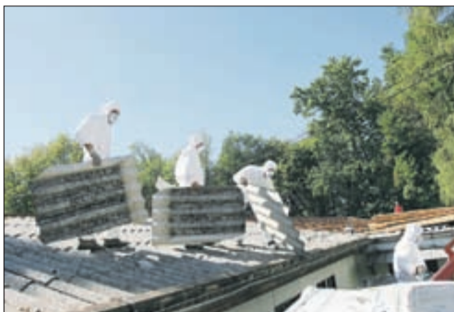
Lani jeseni so na prizidku šole zamenjali dotrajano streho, vendar je v mali telovadnici strop ostal upognjen. / Foto: Tina Dokl
