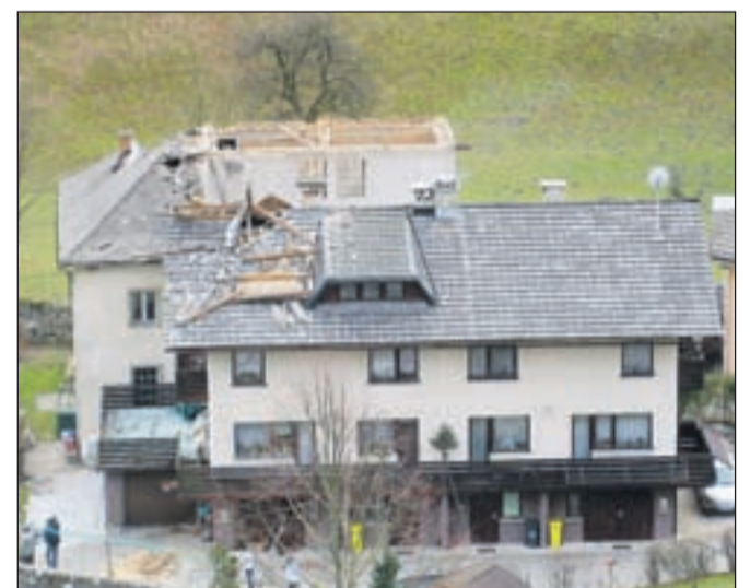
S hidroelektrarne Nika na Racovniku v Železnikih je ostrešje prevrnilo na sosednjo stanovanjsko hišo.
