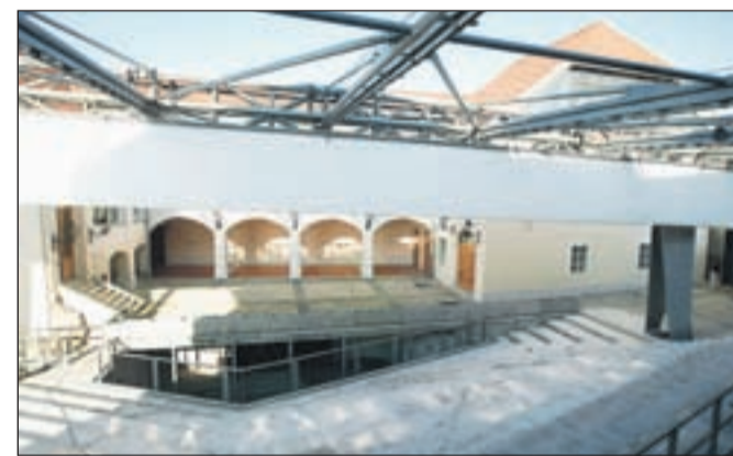
Gradbena dela pri obnovi kompleksa gradu Kieselstein so končana, v obnovljene prostore pa se bo v prihodnjem letu preselil Gorenjski muzej. / Foto: Gorazd Kavčič
