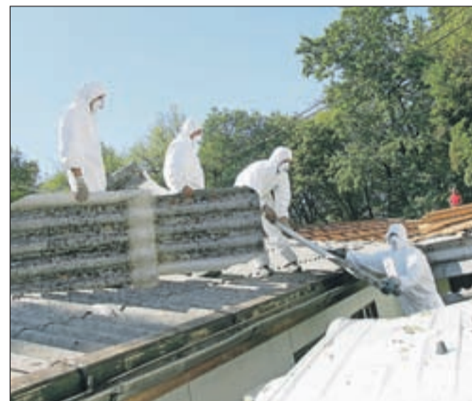
Dotrajano streho iz salonitne kritine so na Osnovni šoli Staneta Žagarja zamenjali še pred prvim jesenskim deževjem. / Foto: Tina Dokl
