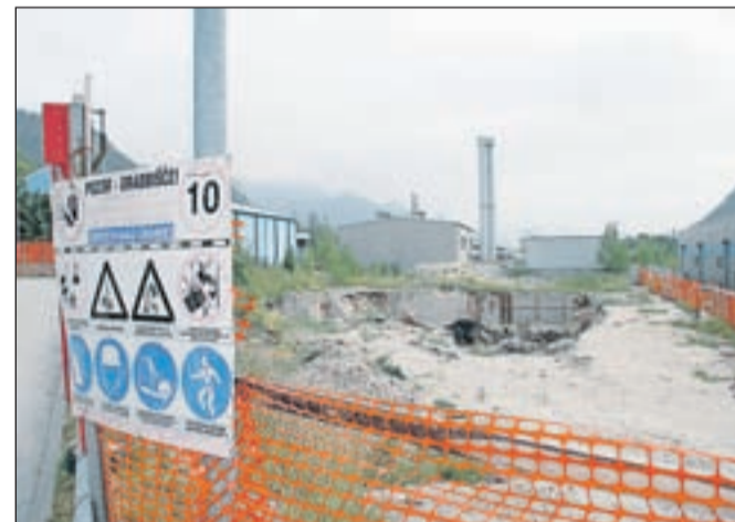
Ob izkopu gradbene jame so naleteli na ostanek bivšega objekta Železarne Jesenice in našli tudi kineto, zalito z mazutom. Pošta Slovenije bo zdaj začela sanacijo območja in nato gradnjo stavbe glavne pošte. / Foto: Andraž Sodja
