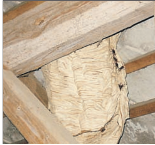
Gnezdo, ki so ga sršeni naredili v ostrejšu ene od stavb na Gorenjskem.
