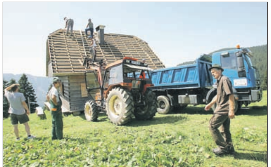
▶ 3. stran Včeraj so na planini Javornik začeli rušiti kočjo Jožefa Perneta. / Foto: Tina Dokl
