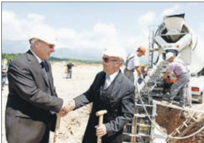
Enega od temeljev novega trgovskega centra bauMax sta Michael Markart in Miro Kozelj zalila z betonom. Z novim centrom bodo tudi Šenčurjani kandidirali za osemdeset novih delovnih mest. / Foto: Gorazd Kavčič
