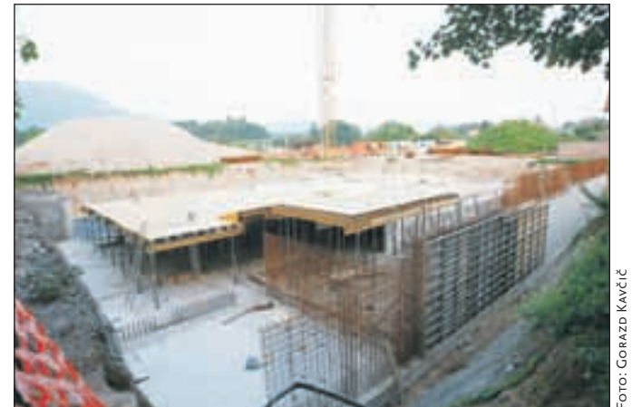
V neposredni bližini doma Dr. Janka Benedika v Radovljici so maja začeli gradnjo oskrbovanih stanovanj. / FOTO: GORAZD KAVČIČ
