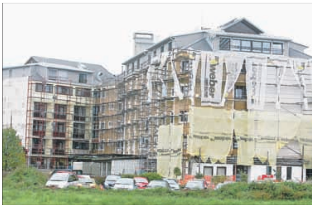
Prenova fasade in menjava oken na stavbi Doma dr. Janka Benedika bo končana do konca tega meseca. / FOTO: GORAZD KAVČIČ
