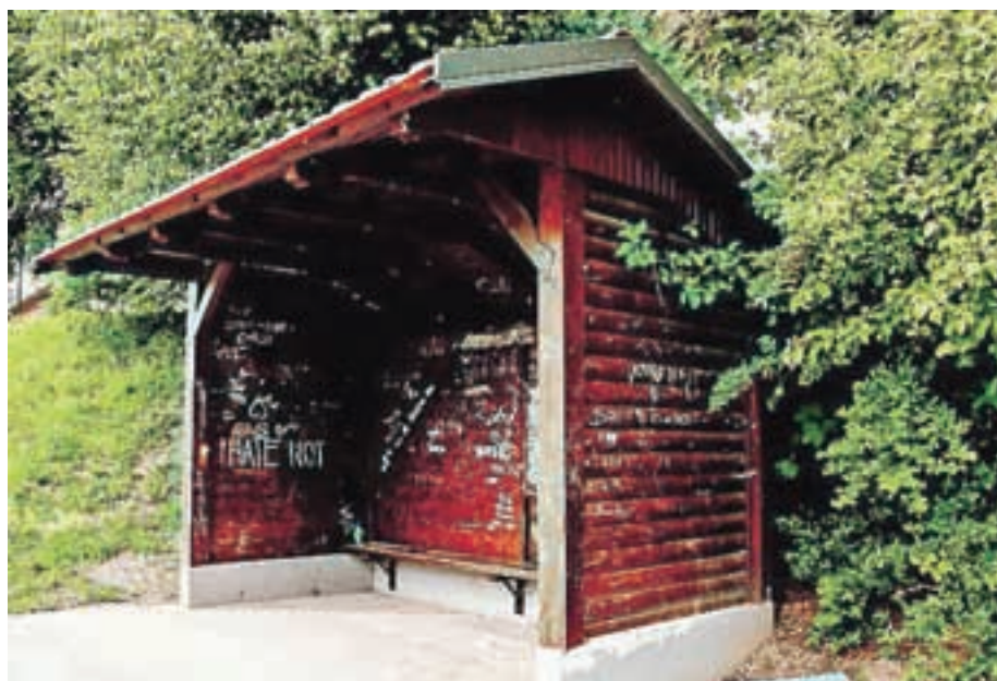
Avtobusna postajališča pred obnovo ...
