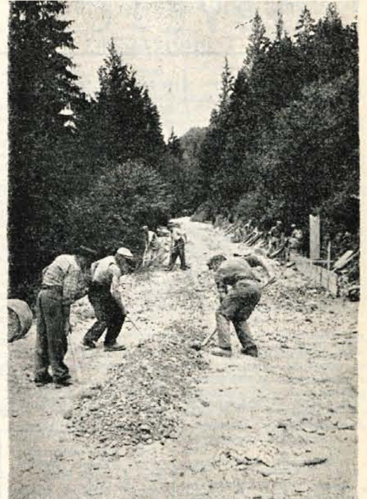
»Ze pred drugo svetovno vojno smo prosili za ureditev ceste na Plavški rovt«, nam je rekel Pavel Klinar, delavec iz železarne, »toda vse je ostalo le pri prošnjah. Imeli smo takšno cesto, da je bila večkrat celo peš neprehojna, kaj šele, da bi lahko prišli na Jesenice z vprežnim vozom. Zatorej lahko razumete, kakšno veselje je za prebivalce šestnajstih hiš v Plavškem rovtu, ko že vidijo skoraj dograjeno novo cesto.« — Otvoritev ceste bo jutri. Zvedeli pa smo tudi, da bodo verjetno že v kratkem začeli tudi z gradnjo ceste na Javorniški rovt. — Na sliki: Zadnja dela na cesti na Plavški rovt
