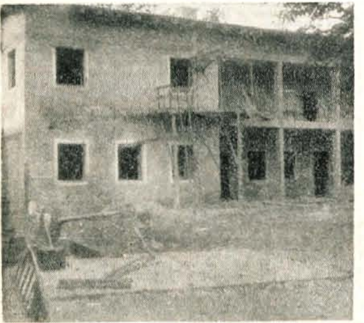
Pogorela stavba Dijaškega doma v Skofji Loki je že pod streho. Sedaj urejajo samo še notranje prostore stavbe. Zaradi prej neprimerne vodovodne napeljave, so se dela pri ureditvi kanalizacije in novega električnega omrežja zavlekla. Do 15. oktobra bo vse urejeno v spodnjih prostorih, to je v jedilnici in kuhinji. Celotna stavba pa bo gotova do konca letošnjega leta. Imela bo še tri večje spalnice in učilnico
