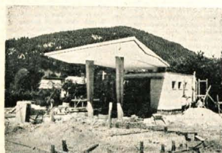
V skladu z asfaltiranjem in preurejanjem cest se čuti po naših krajih tudi velika potreba o servisnih delavnicah in drugih službah, ki jih zahteva sodni turizem. Na sliki: Čeprav ob koncu sezone, vendar bo m. rskoga razveselila nova bencinska črpalka, ki jo končujejo v Bohinjski Bistrici.
