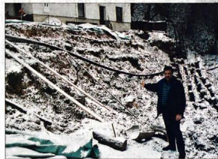
Zemeljski plaz v Zmincu ogroža dve hiši.
