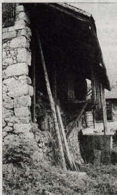
Zlasti pri gospodarskih poslopih se je pokazala stara gradnja: brez temeljev, celo z okroglimi kamni, vmes pa le ilovica. Hlev v vasi Magozd bo potrebno celo ugraditi, da ga bo mogoče varno podreti.
