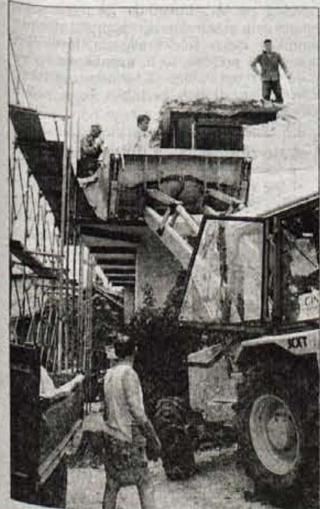
Niso redki primeri, ko sanacija po potresu v sedemdesetih letih ni bila primerna. Nov železobetonski strop le na pol naslonjen na zid, ga je kot nož prerezal. Rešitev je bila samo ena: popraviti napako in nato leto nadzidati.
