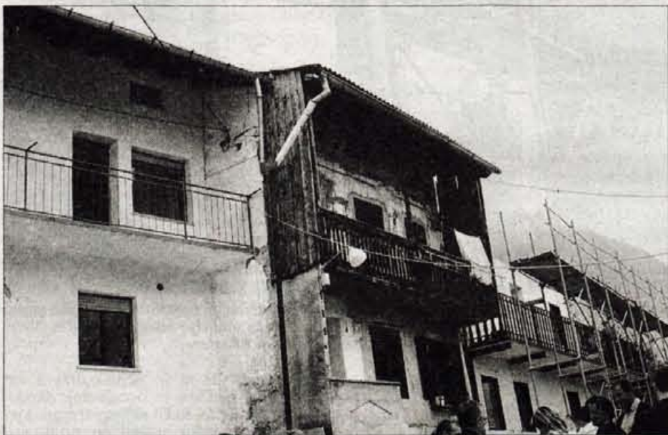
Primer treh medsebojno povezanih hiš: leva je že praktično sanirana, desna je sredi zahtevne rekonstrukcije, lastnik srednje pa se za obnovo ne zmeni. Kako vse to trdno povezati?
