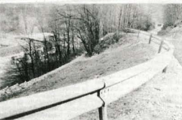
Z denarjem iz proračuna so do zdaj uspeli sanirati le plaz na cesti za Prtovč nad Železniki (na sliki), v programu pa je tudi sanacija plazov pri domačiji Stodlar v Zgornji Sorici.
